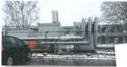
Bestehende Energiezentrale, 25.2.2016, SWB
